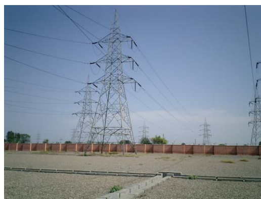
本事業で建設されたジャランダール～ハミルプール送電線
