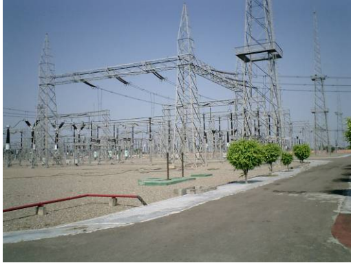
ジャランダール変電所
