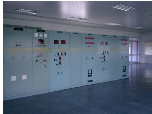
変電所制御室
