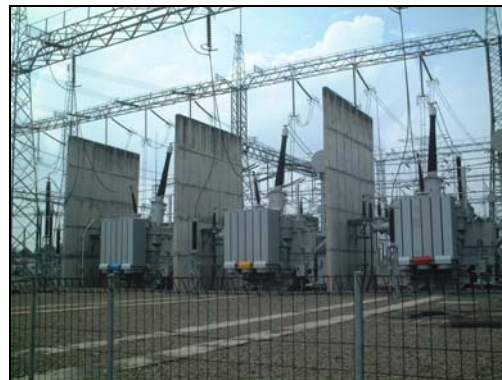
デポックⅢ変電所
