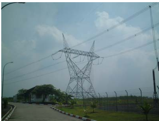
図 4 事業で整備された 500kV 送電線
