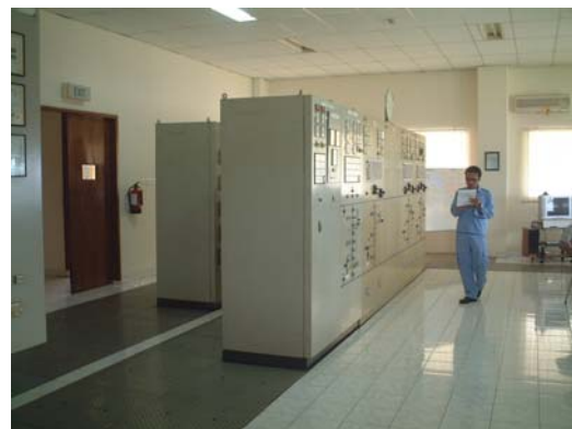
図 5 デポックⅢ変電所管理室
