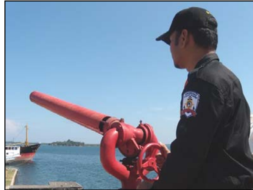
写真 1 防災船 (アルガラ号) の放水銃
