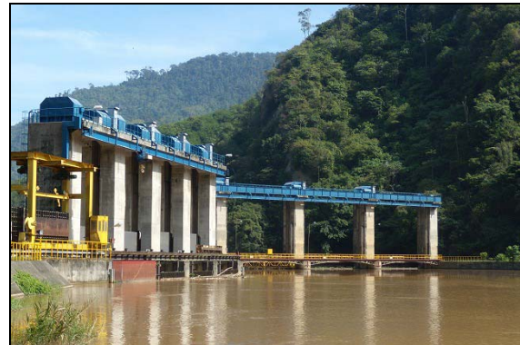
テノンパンギ水力発電所の取水口
