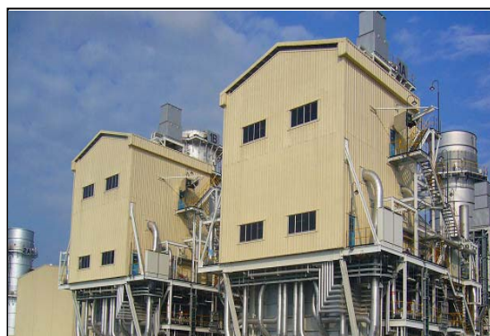
ポートディクソン火力発電所 (本事業の発電設備)
