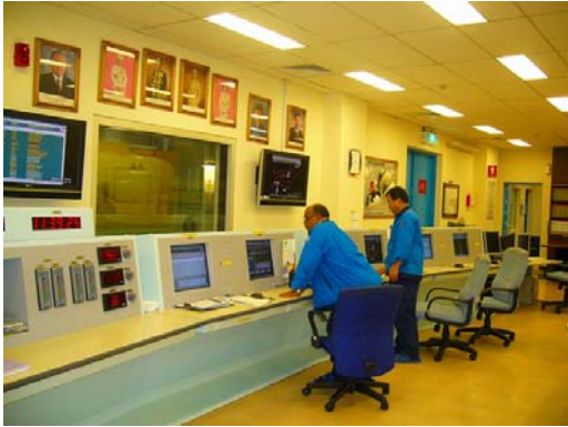
写真 2：コントロール室
