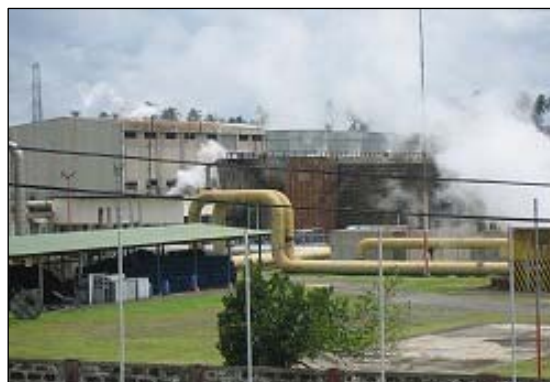
マクバン地熱発電所
