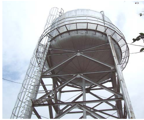
図2 高架貯水タンク
