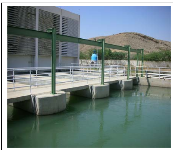
マンゴーピルポンプ場
