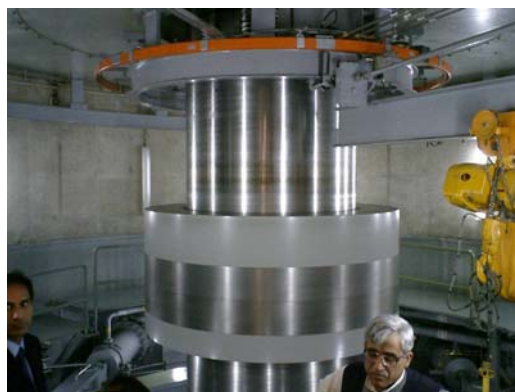
本事業で建設された発電機とタービンを結ぶシャフト
