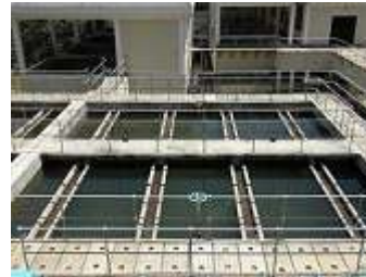
マリimbaダ浄水場沈殿池
