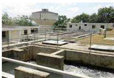
マリンバダ浄水場着水井
