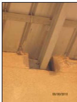
写真3 屋根の梁と外壁の間に隙間ができています (タウア州コニ県)
