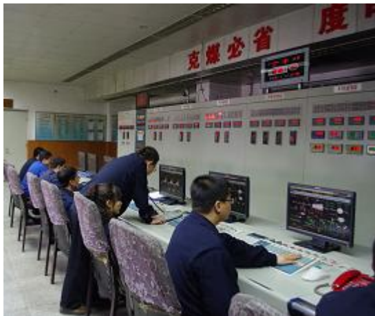
図 6 3-2.密山熱電供給の中央制御室
