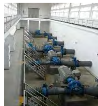
桂林城北浄水場の送水ポンプ
