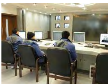
桂林市城北浄水場のオペレーションルーム
