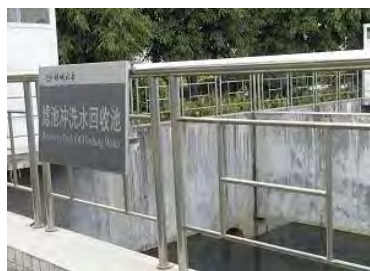
南寧市三津浄水場の生産工程で 使用した水の回収池
