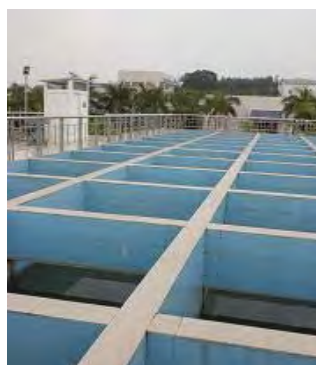
南寧三津浄水場のフロック形成池
