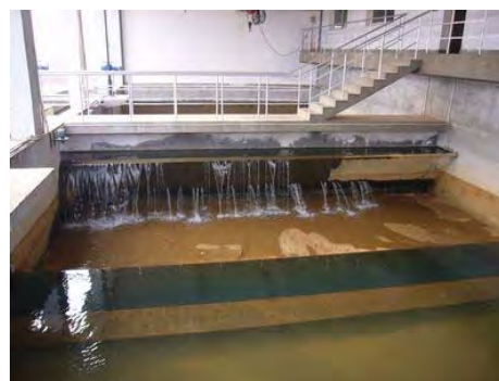
吉安（五岳観浄水場）ろ過池
