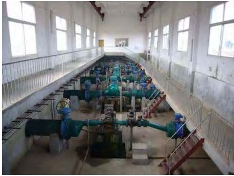
ガン州（第3浄水場）配水場
