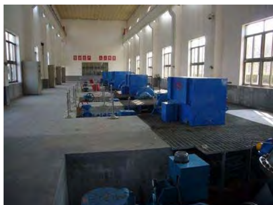
第8浄水場 配水施設
