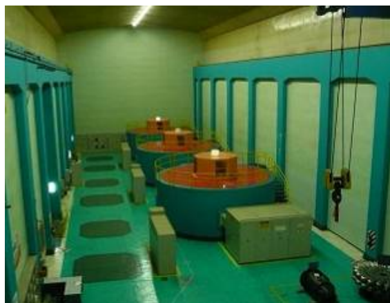
ユンカン水力発電所（地下発電施設）
