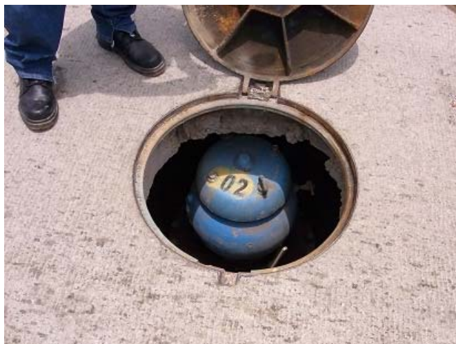
送水管のガス排出口
