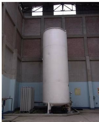
送水管用の酸素貯蔵タンク
