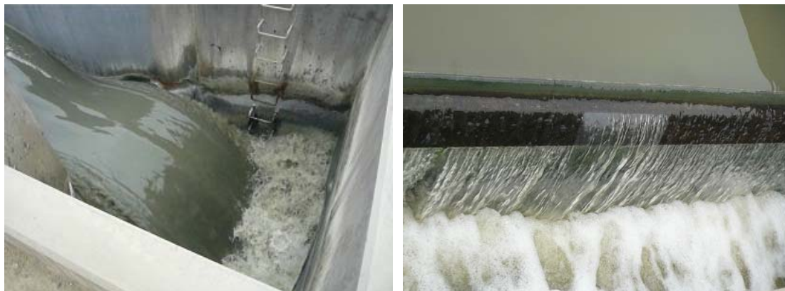
サンバルトロ処理場：(左) 処理前の下水、(右) 処理後の下水
