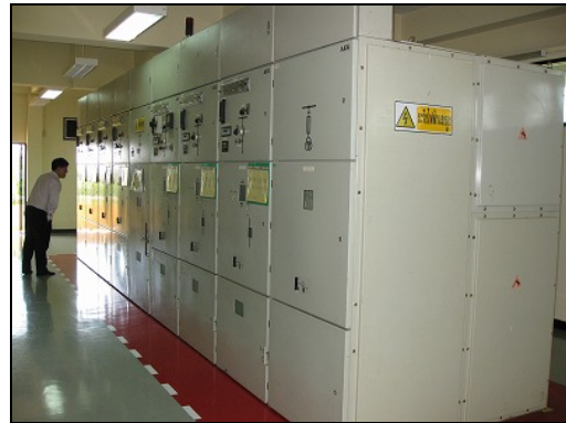
本事業で支援を行った変電設備
