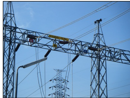
本事業で建設された 115kV 送電線
