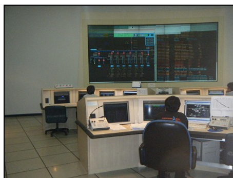
写真1：配電センター
