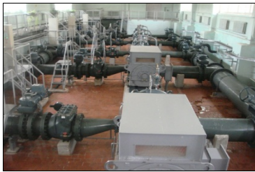
上流水源送水ポンプ
