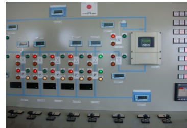
上流水源遠隔操作設備
