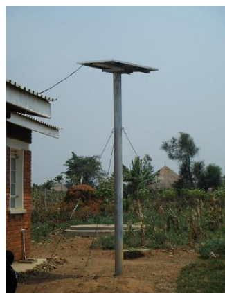
（写真）設置された照明用ソーラーシステム（バンダ保健センターⅢ）
