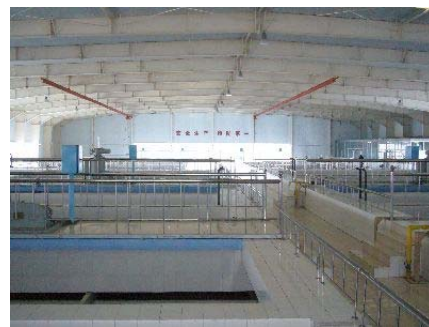
煙台経済技術開発区第2浄水場
