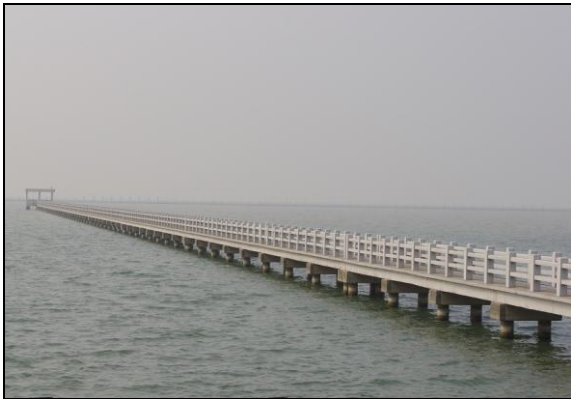
図 6 太湖沿岸の取水口
