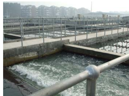
成都市第6浄水場 プラントC (本事業)
