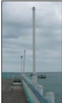
写真-20 電灯 の破損
