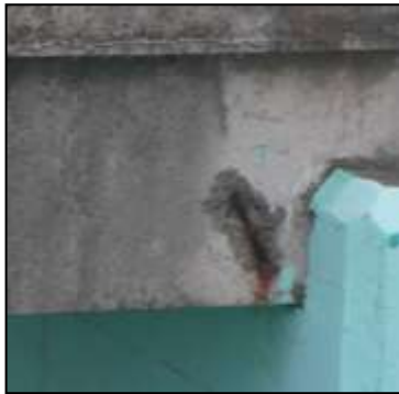
写真-19 コンクリート 剥離箇所
