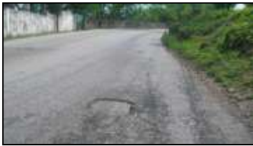
写真-7 道路破損の状況 (ポットホール)
