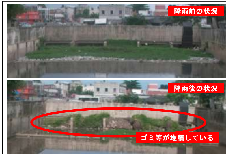
写真-13 降雨前後の暗渠(カルバート)流入口の状況
