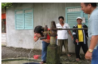
図 5 設置された給水システム
