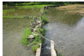
図 4 一部破損してしまった用水路
