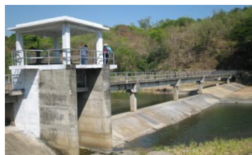
整備された灌漑施設 - 取水堰
