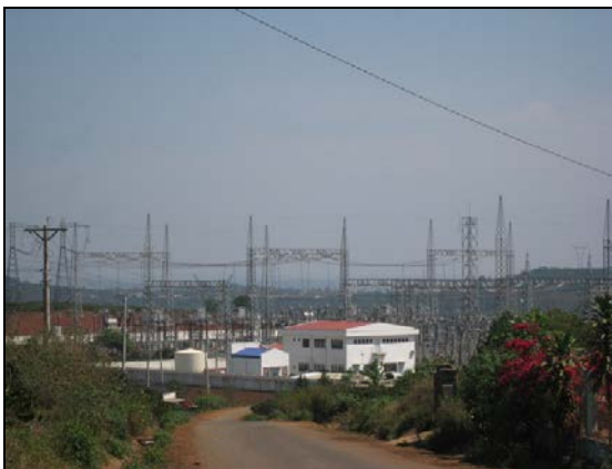
Photo 1: Di Linh Substation
