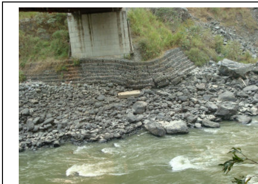
ワクリタル橋護岸（フトン籠工）の沈下
