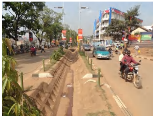
(維持管理の行き届いたエンテベ道路排水溝)
