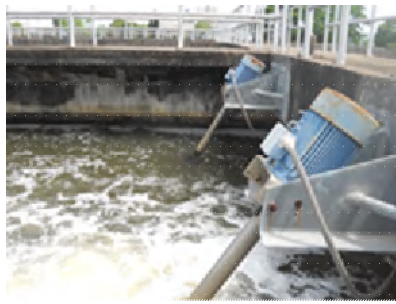
モデル下水処理場の曝気槽
