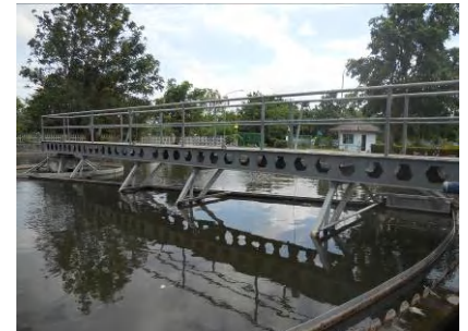
モデル下水処理場の清澄槽
