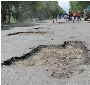
BNT 道路ポットホール修繕 （2012 年 6 月 5 日）
