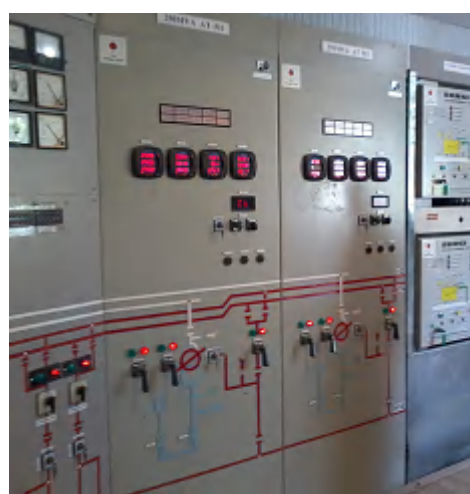
(変電所制御棟内の主変圧器用制御盤)
