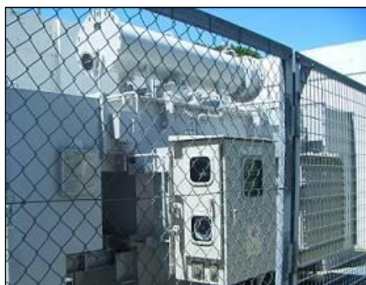
ラナディ変電所：主変圧器
