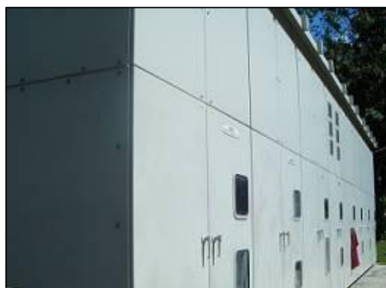
ホニアラ開閉設備
