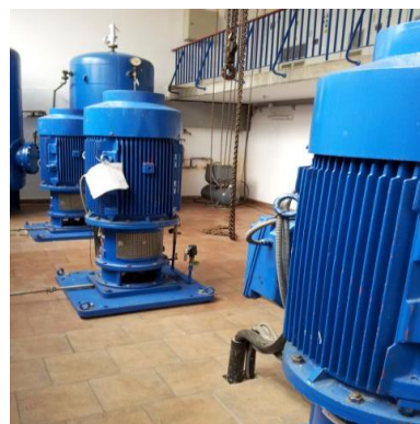
本事業で PS-15 に設置されたポンプ
