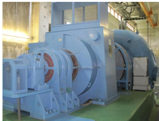
本事業で整備した発電機
