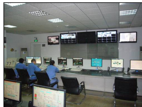
高炉ガスコンバインドサイクル発電設備（運転管理センター）
