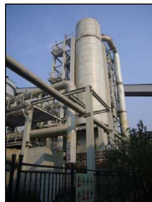
コークス炉ガス処理設備（脱硫設備）
