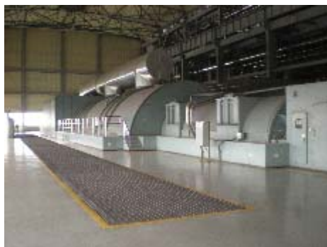
タービン発電機
