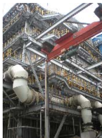
排煙脱硫装置
