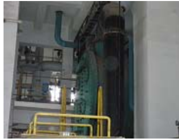
余熱発電システムのタービン
