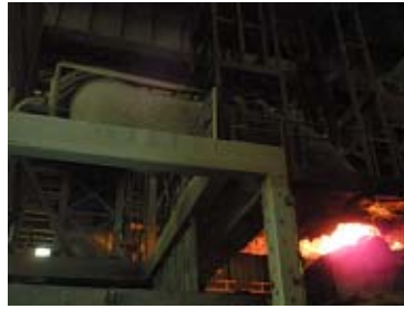
AOD 製錬炉及び集塵設備
