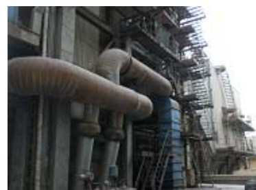
発電施設外観
