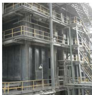
設置された脱硫装置全貌
