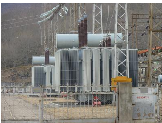
図1 更新された変圧器
