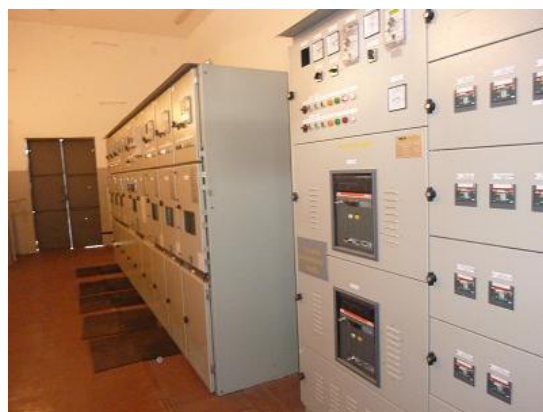
図2 更新された配電機器
