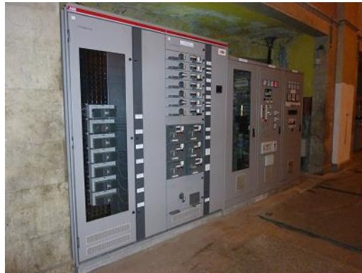
図4 更新された配電盤・機器
