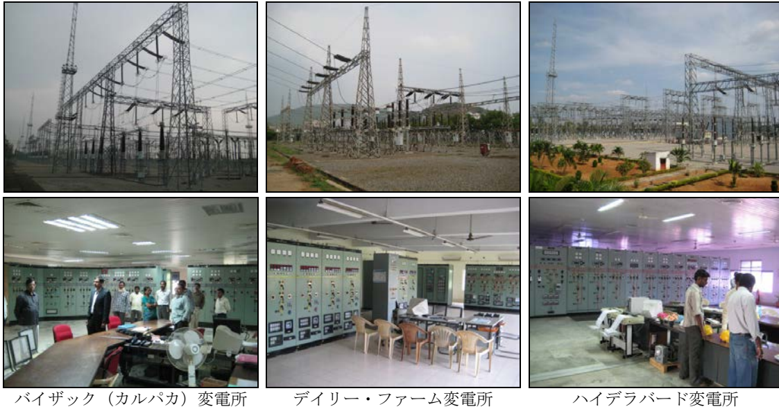
バイザック（カルパカ）変電所
