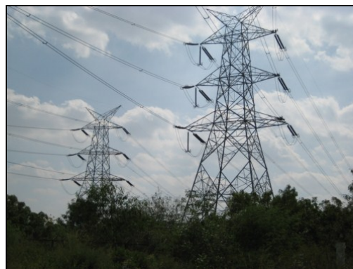
本事業で建設した 400KV 送電線
