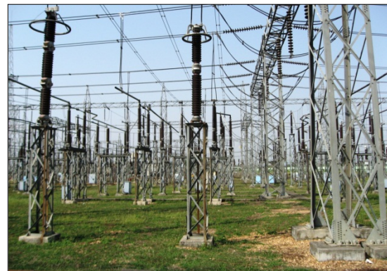
アランバグ変電所の増設設備
