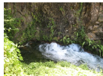
写真 漏水湧出部
