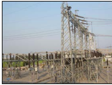
クロン克蘭変電所
