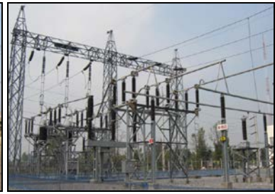
プランクラタイ変電所
