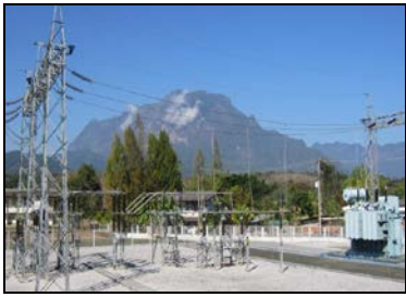
チンダオ変電所
