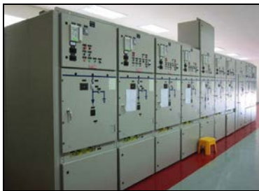
チンダオ変電所配電盤
