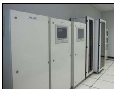
送電線保守情報システム
