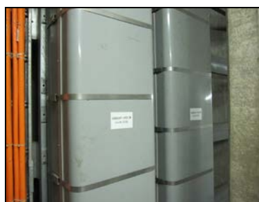
送電線トラフ
