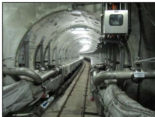
本事業で建設されたトンネル及び送電線
