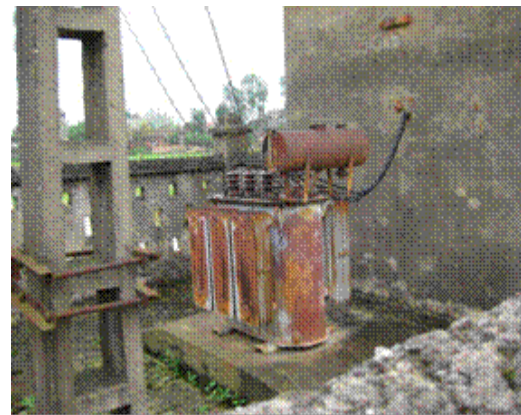
古い変圧器の状態
