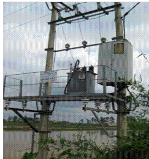
バクニン省で建設された変電施設
