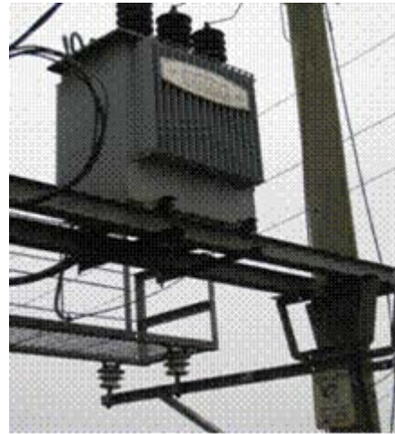
ベトナム国産の柱上変圧器
