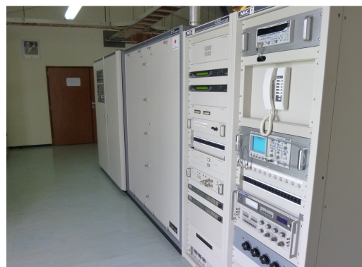
図 12：マワガ送信所内にて 調達・据付された送信機材
