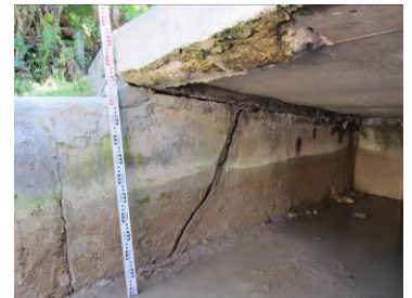
水路橋直下水路側壁部亀裂
