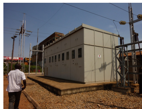
調達された 33kV 開閉設備 (東部イガンガ県・イガンガ変電所内)
