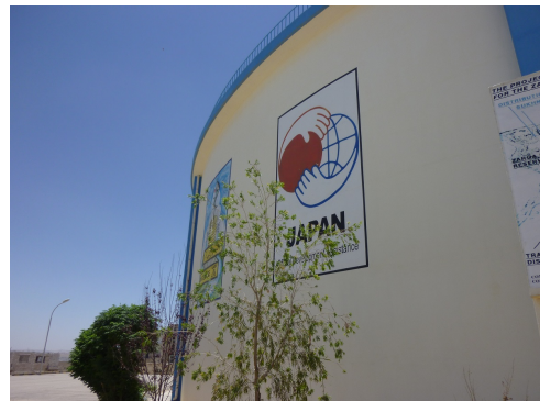
バトラウィ配水池
